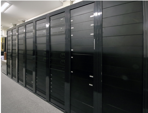
非常用放送設備のパワーアンプ架。
