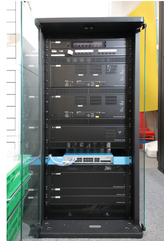
地下1階～3階の商業施設共用エリアのBGM放送機器が収められたワゴン。
