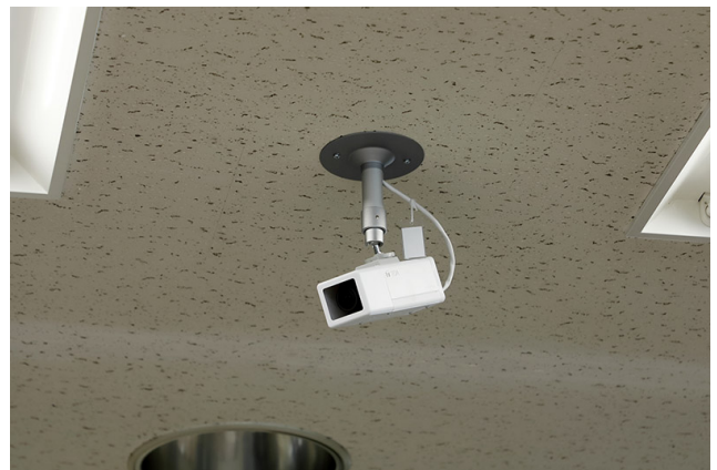
ホールディングルーム（搭乗待合室）の天井に設置されているフルHDネットワークカメラN-C5120-3。
