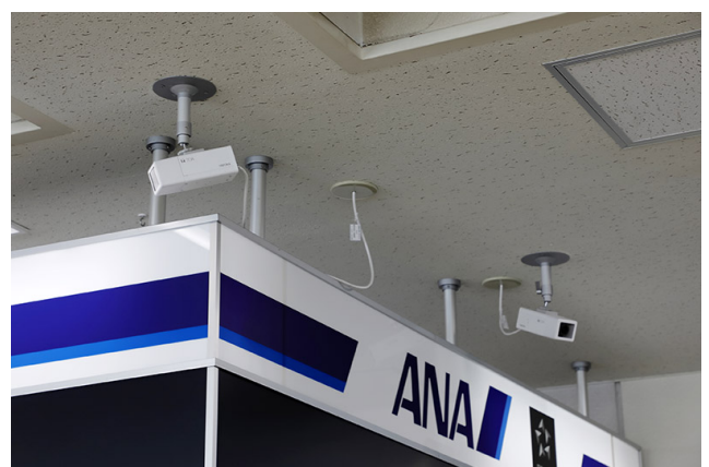
チェックインカウンターに設置されたネットワークカメラTRIFORAシリーズのフルHDネットワークカメラN-C5120-3。
