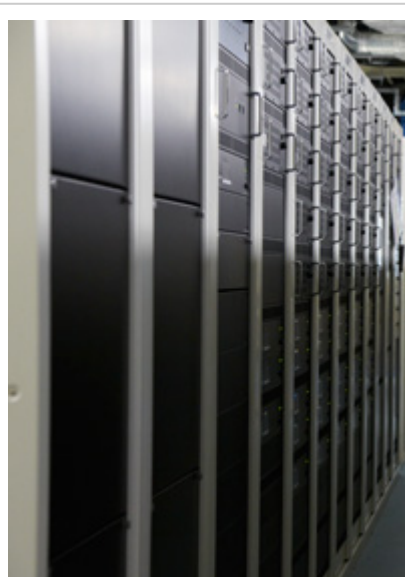
非常放送架 国際線旅客ターミナルビルの非常放送を制御する心臓部。放送操作部やパワーアンプなどが収納されたラックが整然と並びます。
