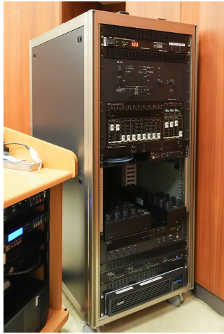
赤外線会議システムのセンター装置などが収納されたラック。
