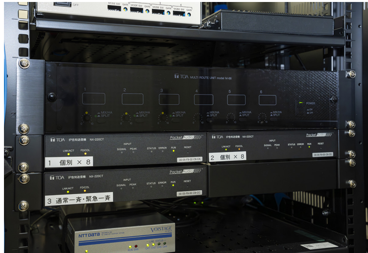
IP告知送信機 NX-220CTもラックに収められている。
