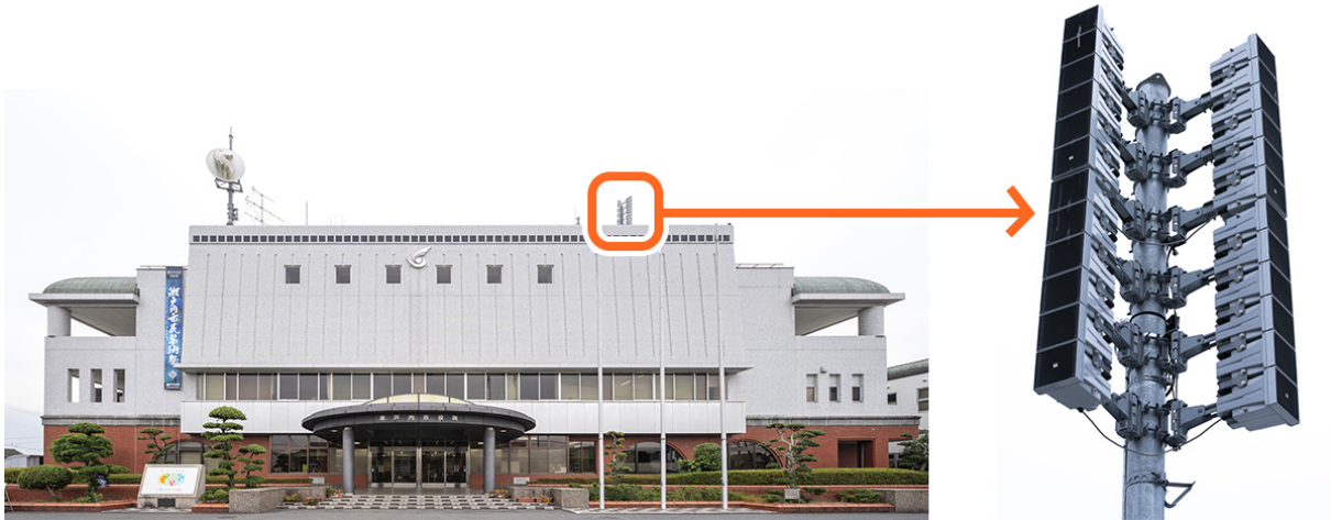
瀬戸内市役所の屋上に設置された防災情報伝達システムの高性能スピーカー。
