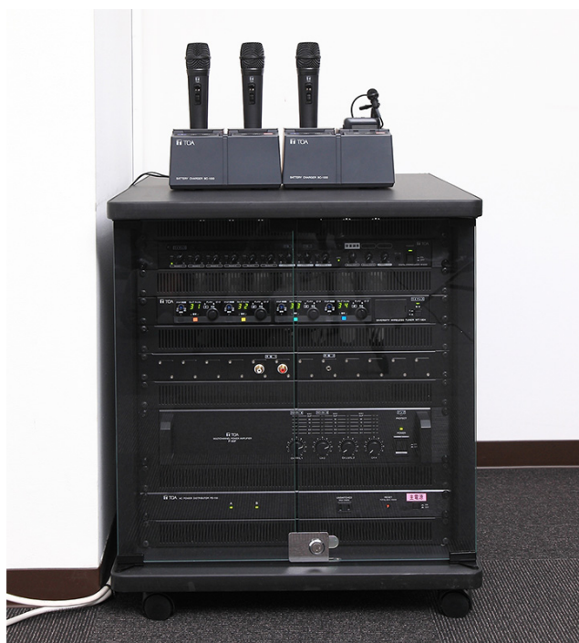
会議室後方のアンプ架。デジタルステレオミキサーM-633Dにより、ハウリングも抑制でき、明瞭な音を届けている。
