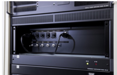
予備アンプへの切替パッチパネル。不具合や故障が起こった際に、手動でアンプを切り替える。
