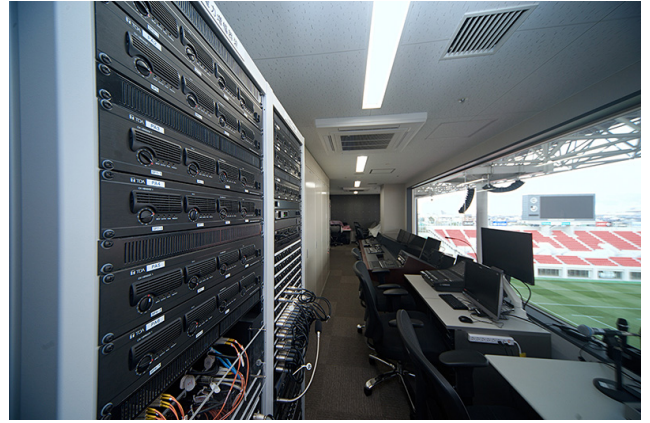
調整室の中に設置された電力増幅架。デジタルパワーアンプ、デジタルワイヤレスチューナーなどが収納されている。
