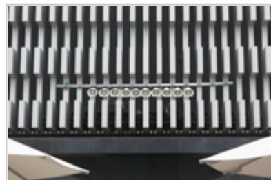
中国館の周囲に設置されたスピーカー
