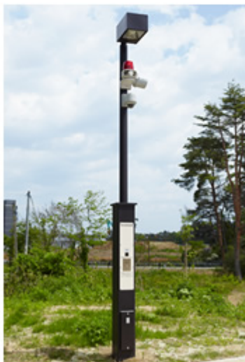
緊急通報システムを設置した防犯灯
