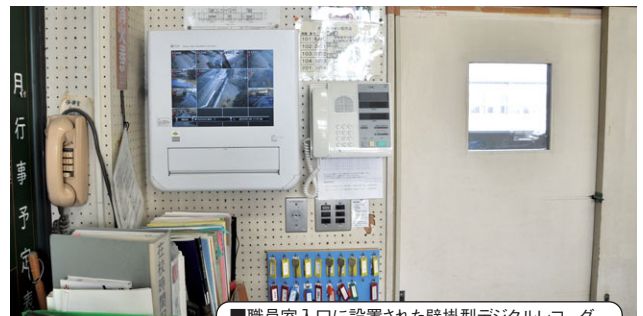
■職員室入口に設置された壁掛型デジタルレコーダー
